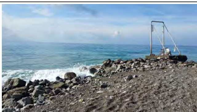
Punto attracco con portale e massi in cls scalzati
